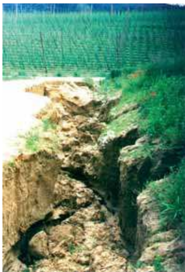
Bild 2: Ausgespülter Weg/Graben durch abfließendes Oberflächenwasser
